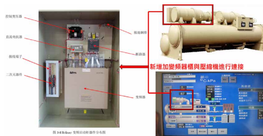
圖 3-8 300kW 变频器启动柜内部结构
