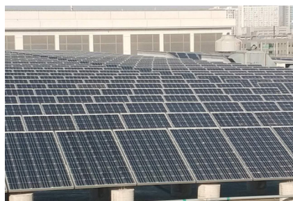
● 昆山光電廠 - 太陽能發電設備
