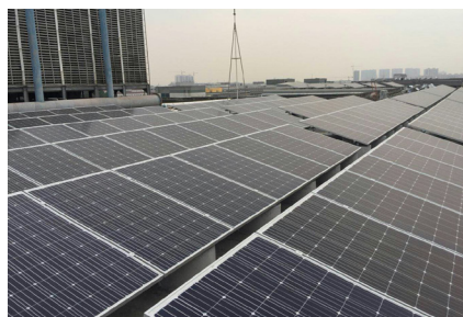
● 中山廠 - 太陽能發電設備
